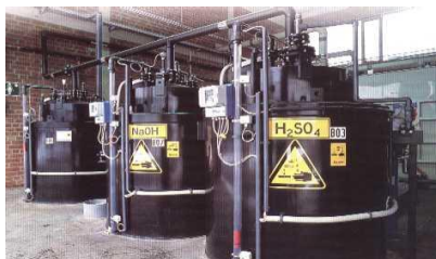
Umgang mit Abwasser und wassergefährdenden Stoffen
